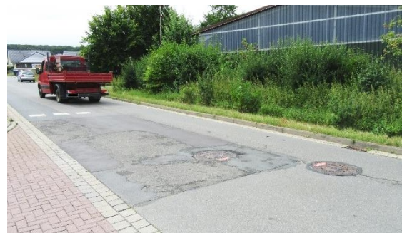
Foto: Fahrbahnschäden Stukenbergweg in Lichtenberg, aufgrund Tempo-30 und geringer Verkehrsmengen eher unkritisch
